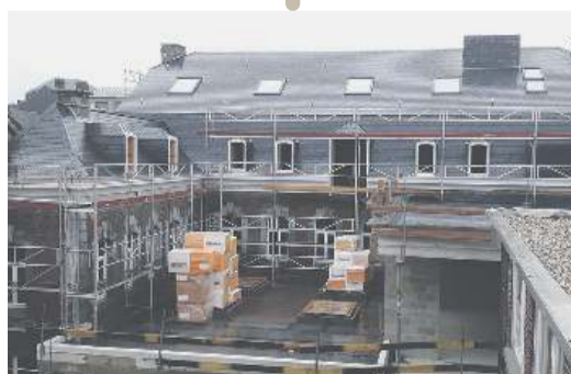
Im Juli 2021 war das Dach des mittleren Gebäudes ebenfalls fertig und die neuen Fenster zum Teil bereits eingesetzt.
