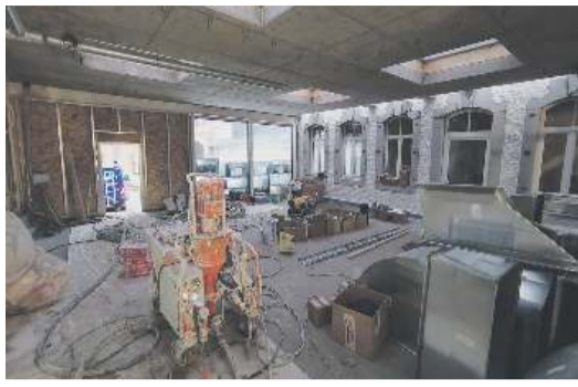
Hier herrschte noch reges Baustellen- treiben. Man erkennt jedoch schon die in weiß gestrichene Fassade und die großen Glasscheiben. Eine Eingangstür wurde provisorisch installiert.
