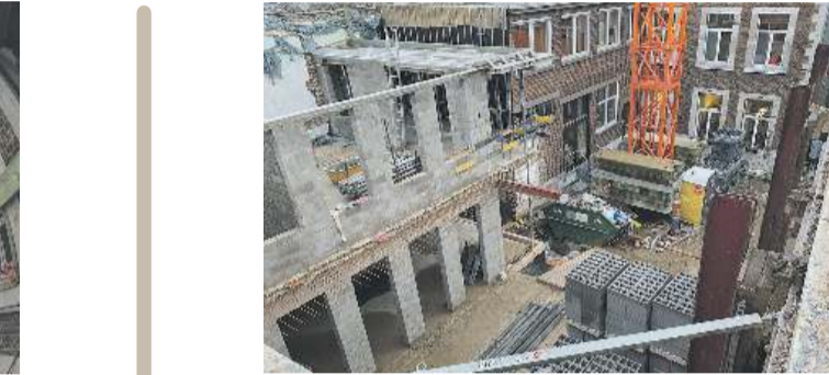
Im Dezember 2020 standen die Grund- mauern des neuen Anbaus (links), der später im Erdgeschoss einen Pausenraum und im Obergeschoss eine Wohnung beherbergen würde.
