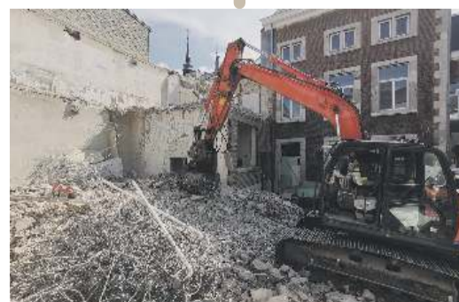
Nun galt es den Innenhof auf Vorder- mann zu bringen. Jetzt wurde der letzte Teil des für die Rotationsdruckma- schinen benötigten Gebäudes abgerissen.
